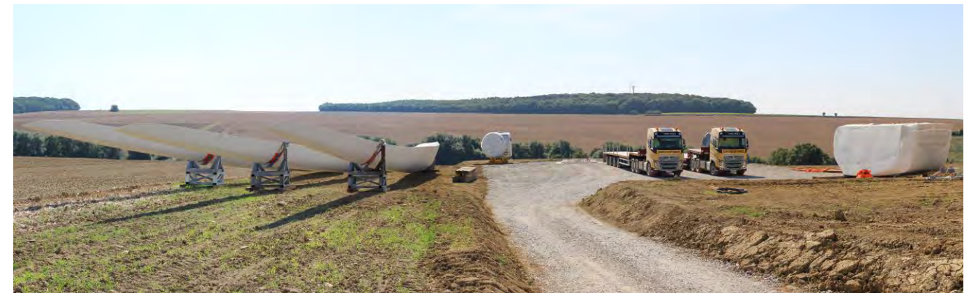
Eléments d'éoliennes avant montage (Source : Ora environnement)
