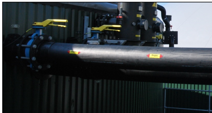
EXEMPLE DE CANALISATION DE TRANSPORT DE BIOGAZ
