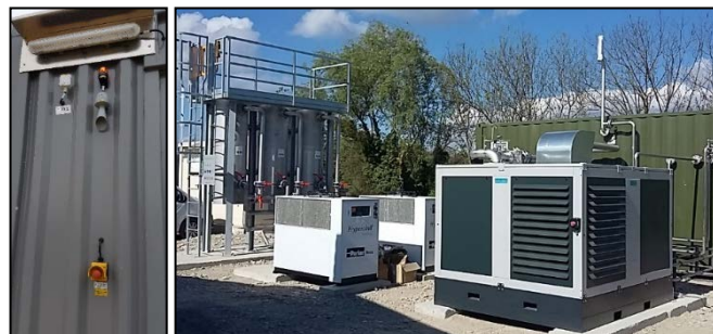
EXEMPLE DE BOUTON POUSSOIR D'ARRÊT D'URGENCE SUR LE CONTAINER D'EPURATION ACCOMPAGNE DE L'EQUIPEMENT DE L'ALARME LUMINEUSE ET SONORE - EXEMPLE DE BOUTON POUSSOIR D'ARRÊT D'URGENCE SUR LE COMPRESSEUR
