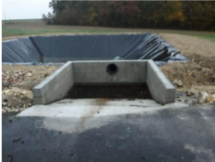
Figure 13 : Vue sur un système de décantation primaire
