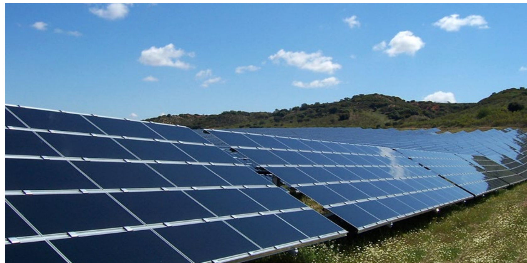
Parc photovoltaïque EDF Renouvelables de Narbonne
