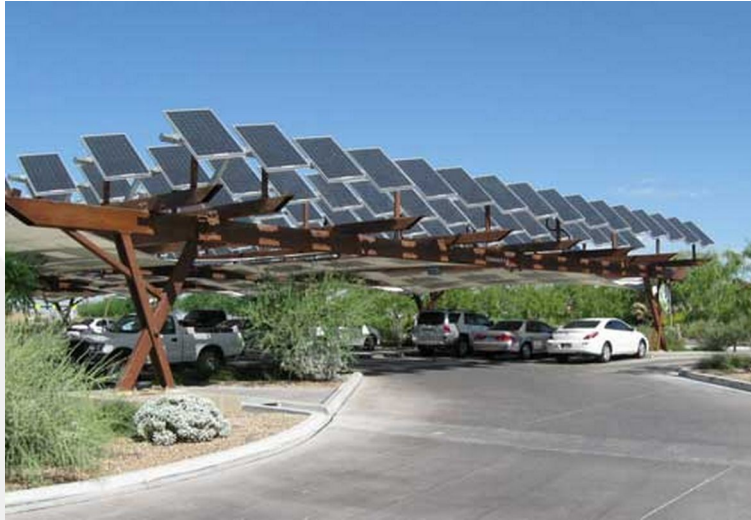
Ombrières photovoltaïques installées sur un parking
