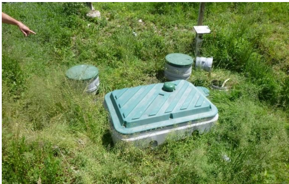
Photo n° 16 : micro station in situ sur l'élevage : on retrouve la trappe rectangulaire et les deux tampons circulaires
