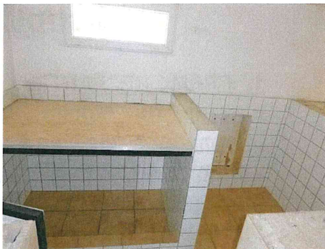
Photo 2 : aspect d'un box, avec accès au parc par la trappe visible sur la droite. Le plafond de la niche est chauffant
