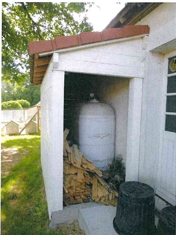
Photo 33 : Cuve à fioul située à l'arrière du bâtiment n° 2
