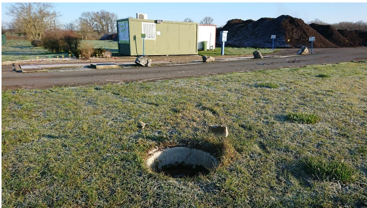
Figure 16 : Séparateur à hydrocarbure en aval de la zone d'accueil et pont à bascule
