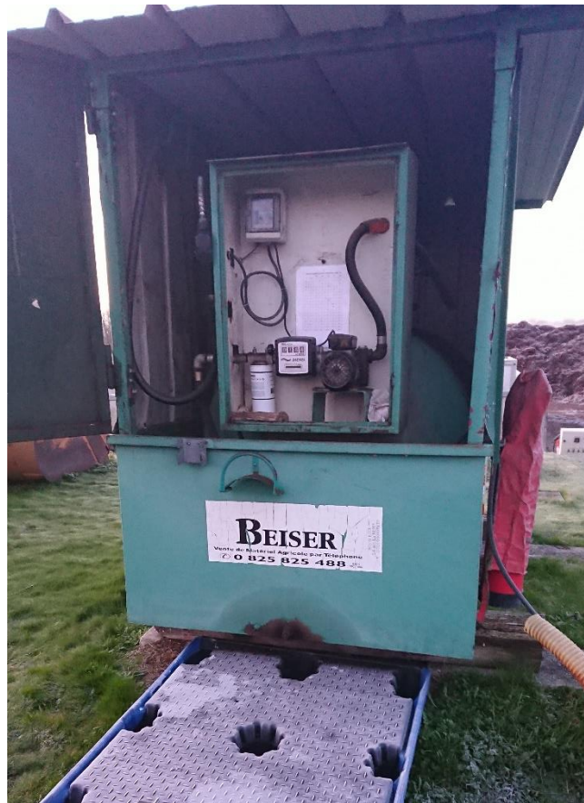
Figure 17 : Vue sur la cuve de GNR
