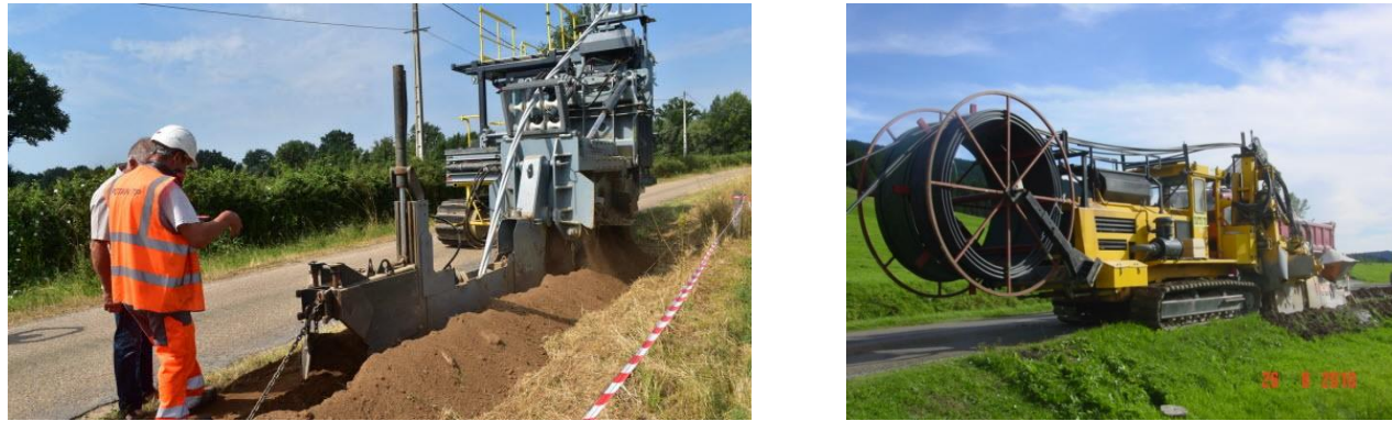
Figure 24 : Exemple de trancheuse en action (Source : Le Journal de Saône et Loire ; Tattu TP)
