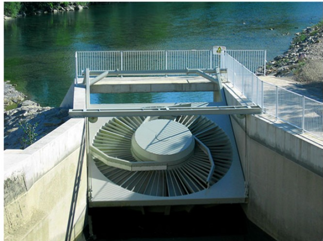
Distributeur avec dégrilleur rotatif
